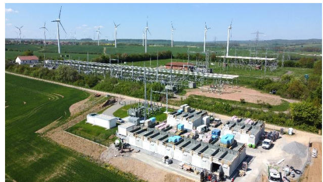
Smareg 4 Projekt in Eisenach, Deutschland. Quelle: Smart Power
