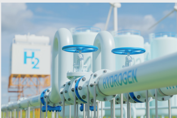
Conduite d'hydrogène. Source: Adobe Photostock
